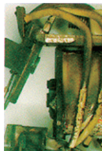
過電流・電圧による焼損
