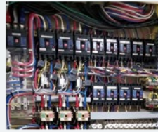
제어반 내부 온도 상승에 의한 기기의 과열
